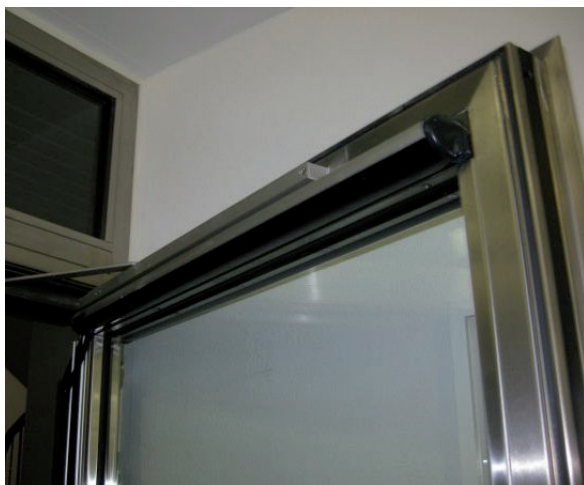
Bild 6 Infrarotvorhangschiene zur Anwesenheitskontrolle
